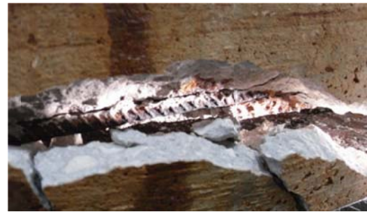
(d) concrete cover delamination
